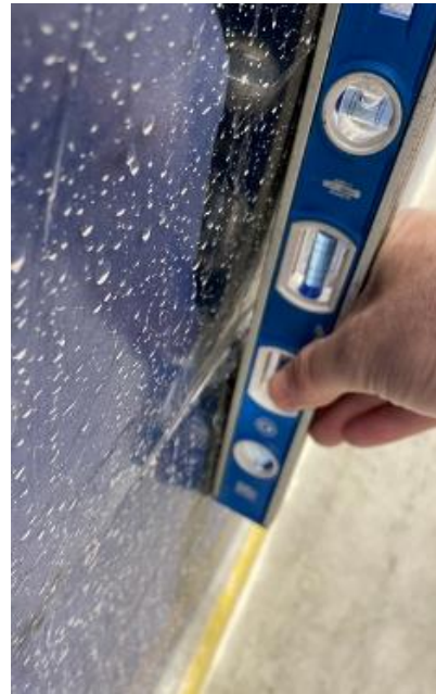
#6 Door frame bent.
